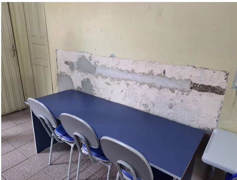
Parede com má qualidade de acabamento
