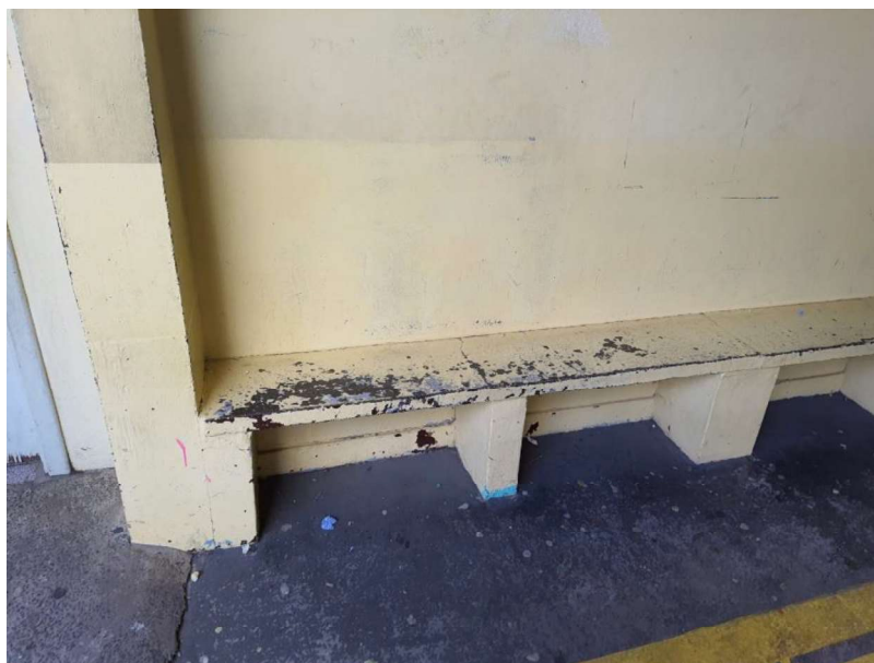
Pintura em mau estado de conservação
