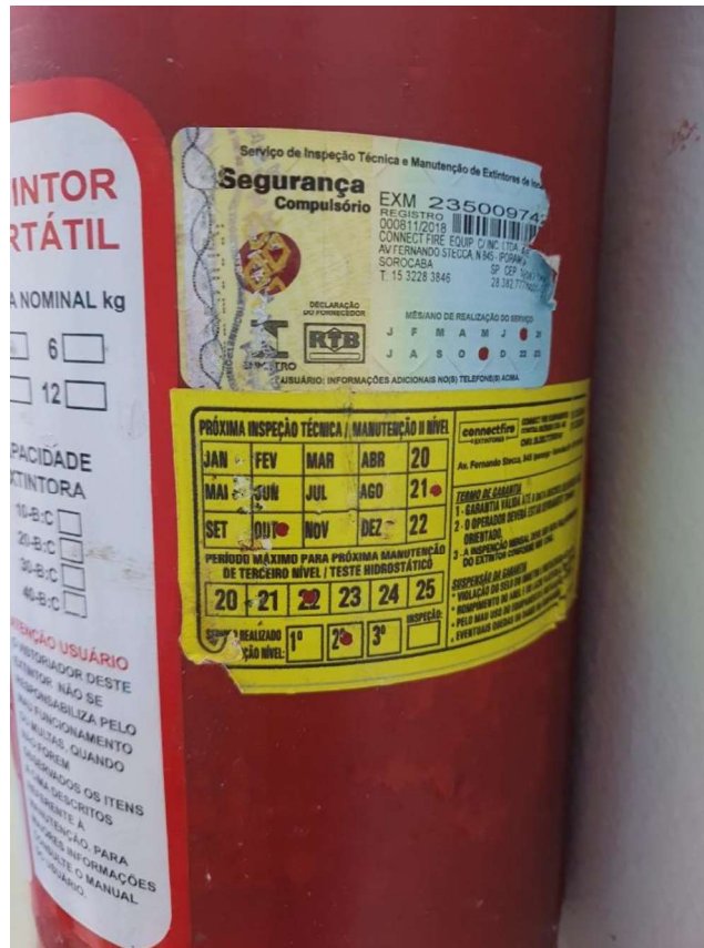
Extintor de incêndio vencido
