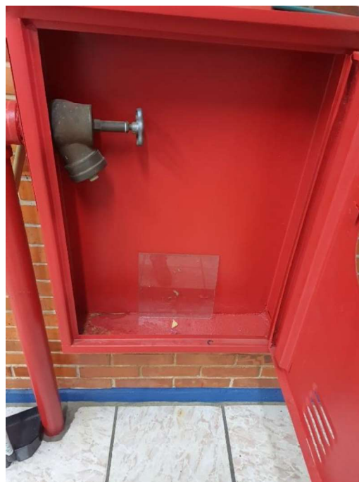
Ausência de mangueira de combate à incêndio
