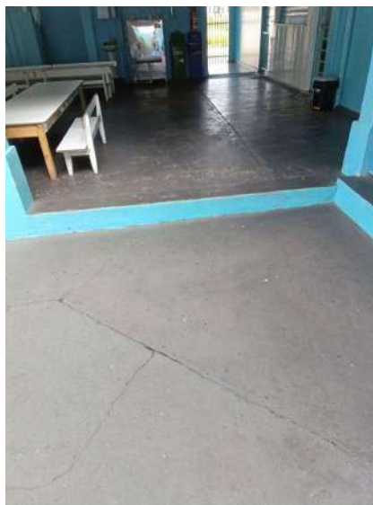
ausência de rampa no acesso para a área de recreação
