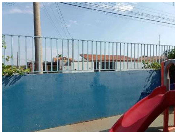
ausência de cercantilha
