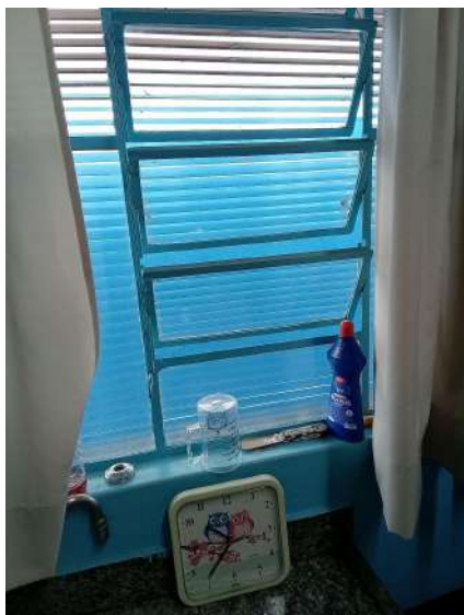
ausência de telas milimetradas
